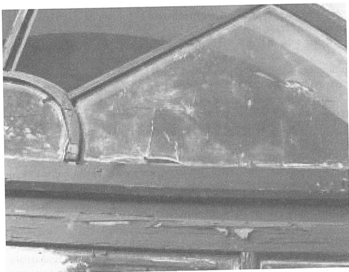
Foto-2: wybite okna na parterze do których strzelano z wiatrówki 3 razy (!!!)
