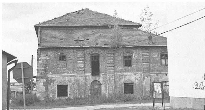
Synagoga w Cieszanowie przed remontem
